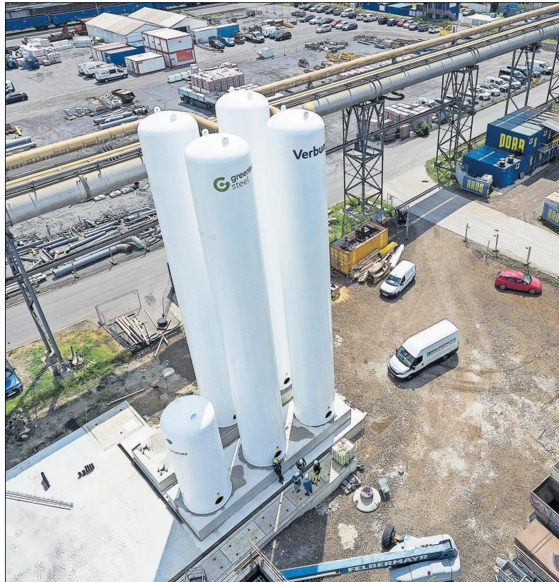
Die neuen Speichertanks der H2FUTURE-Follow-up-Anlage auf dem Gelände der voestalpine in Linz. [Verbund AG]
